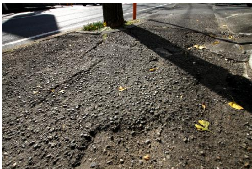
図 3-4 老朽化し塗装のはがれた歩道
